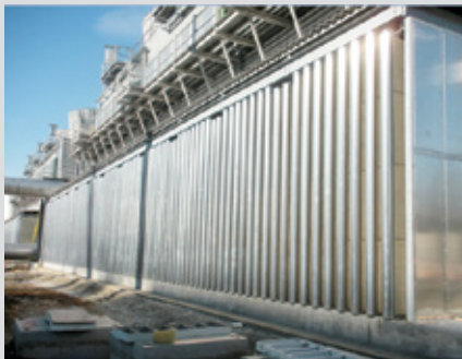
Insonorizzazione torre evaporativa
